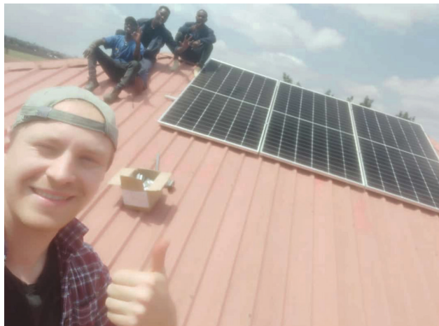
Abb1: Aufbau Solarplatten auf Gebäuden in Kenia.
